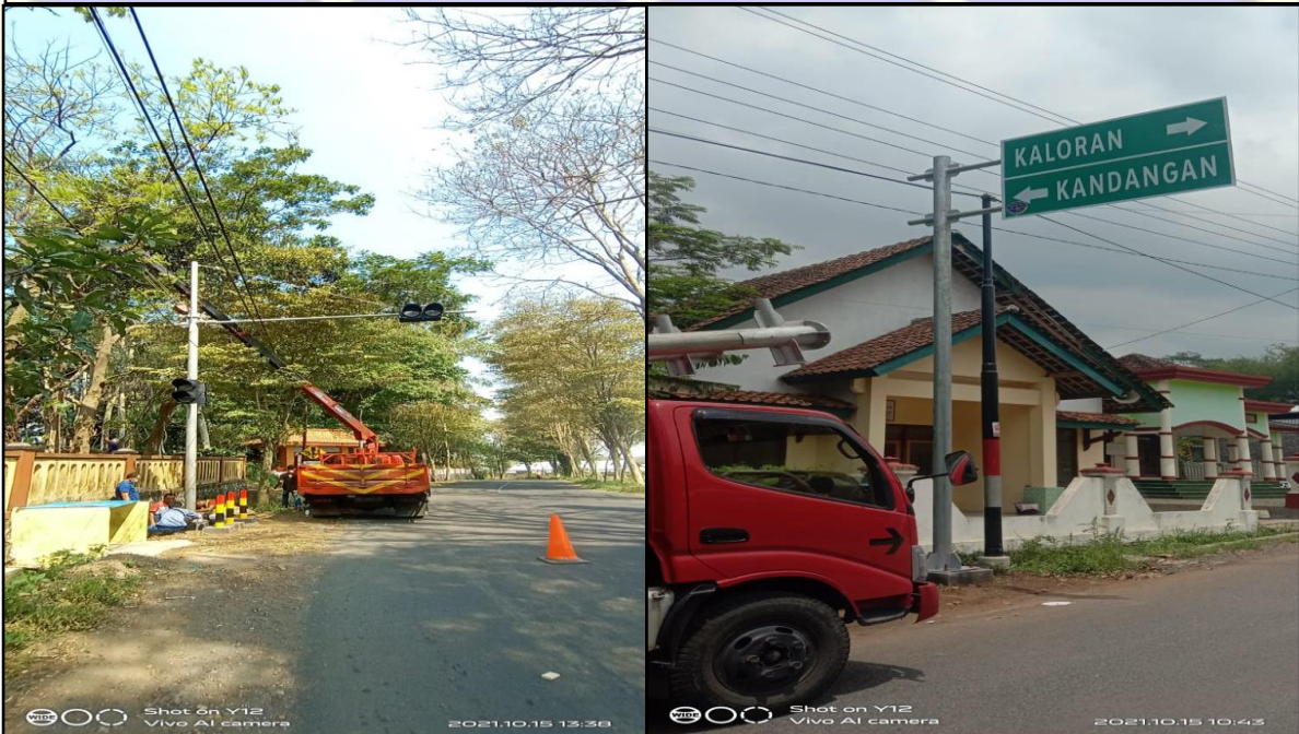
Gbr. 3.5.1 Perengkapan jalan
