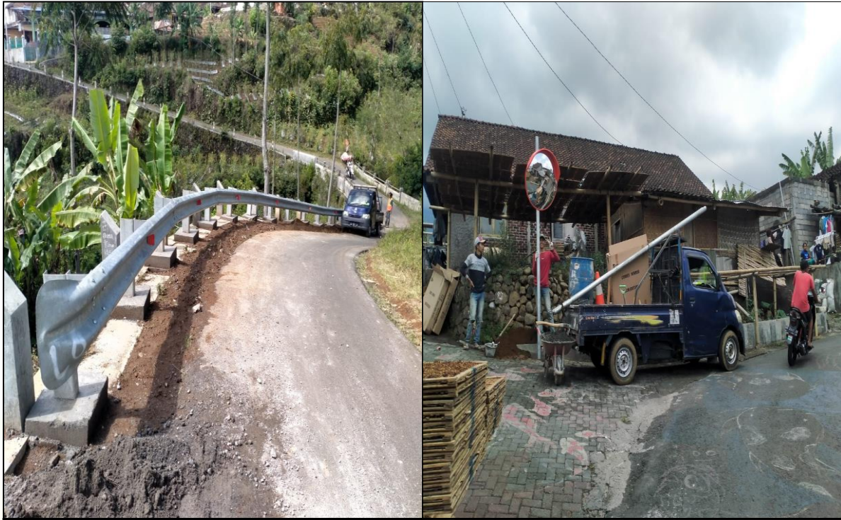
Pemasangan Pagar pengaman Jalan (Guardrail 0 dan Cermin tikungan di Desa Katekan Kec. Ngadirejo
